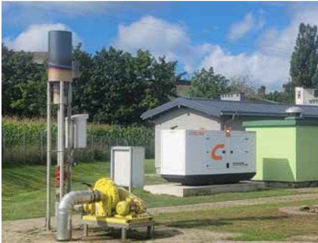
● Automatyczna świeca gazowa w instalacji „Perkun”
