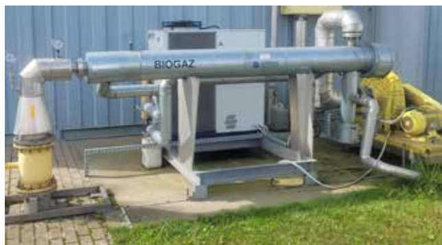
● Przepompownia i uzdatnianie biogazu
